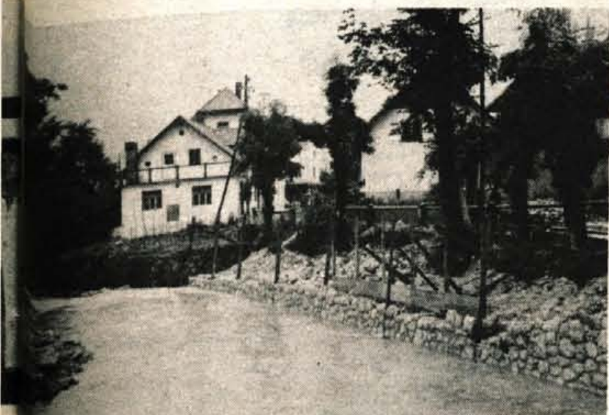
Škofja Bistrica — Poleg lepo urejenega muzeja Tomača Godca v Bistriki nameravajo postaviti za obiskovalce še klopi in tudi sicer se urediti okolico. Zdaj so morali ob potoku, ki teče mimo muzeja, primerno postaviti obrežje in so zgradili oporne zidove. — Foto: Pauli Mencinger
