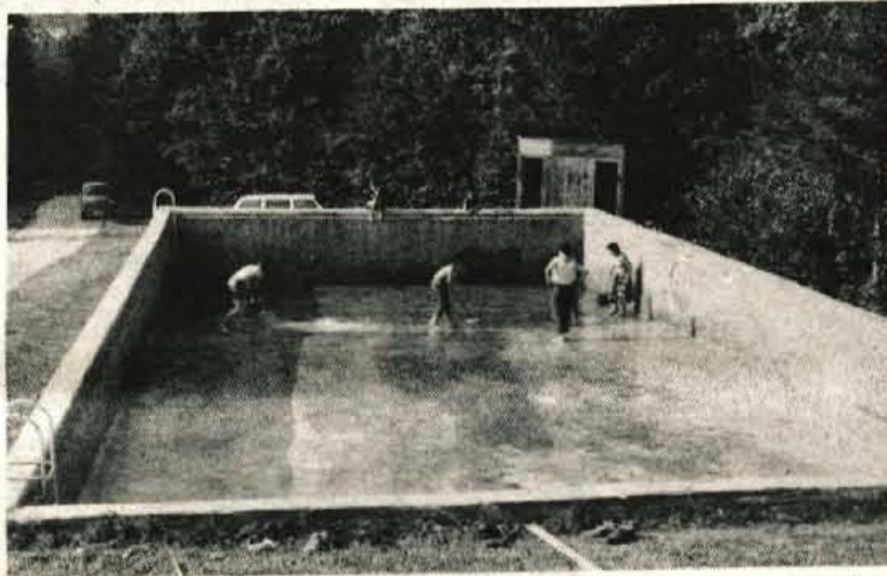
Krajani so sami zgradili kopalnišče v Nemiljah. Veliko najmlajših se je v njem naučilo plavati. Vendar bo treba objekt popraviti. Domačini so se že lotili dela
