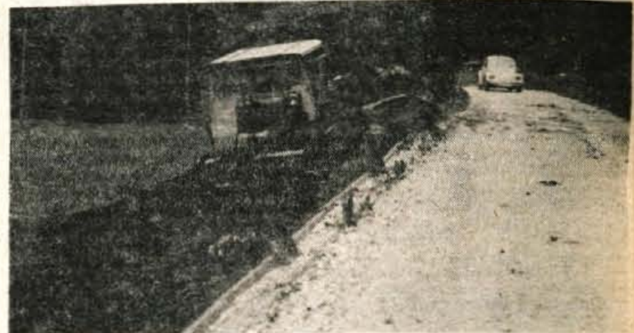
V tržiški občini so že začeli urejati cesto Slap-Čadovlje. Predno pa bodo cestnišče utrdili in asfaltirali, bo potrebno traso razširiti in zgraditi oporne zidove ob bregih in Tržiški Bistrici. — H. Jelovčan
