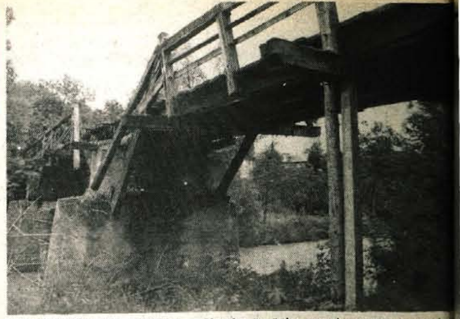
NEVARNOST NA MOSTU — Več let že čaka napol porušen in omajan leseni most čez Kokro pod Hujami na popravilo. Zaradi dotrajanosti so ga že zaprli za ves motorni promet in je dovoljen le prehod za pešce. Pa še ti na tem mostu niso več varni. O ograji praktično ni mogoče več govoriti, zato podrtje še bolj izživlja nevarnost. Kaj bi bilo, če bi kdo omahnil v Kokro... (jk) — Foto: F. Perdan
