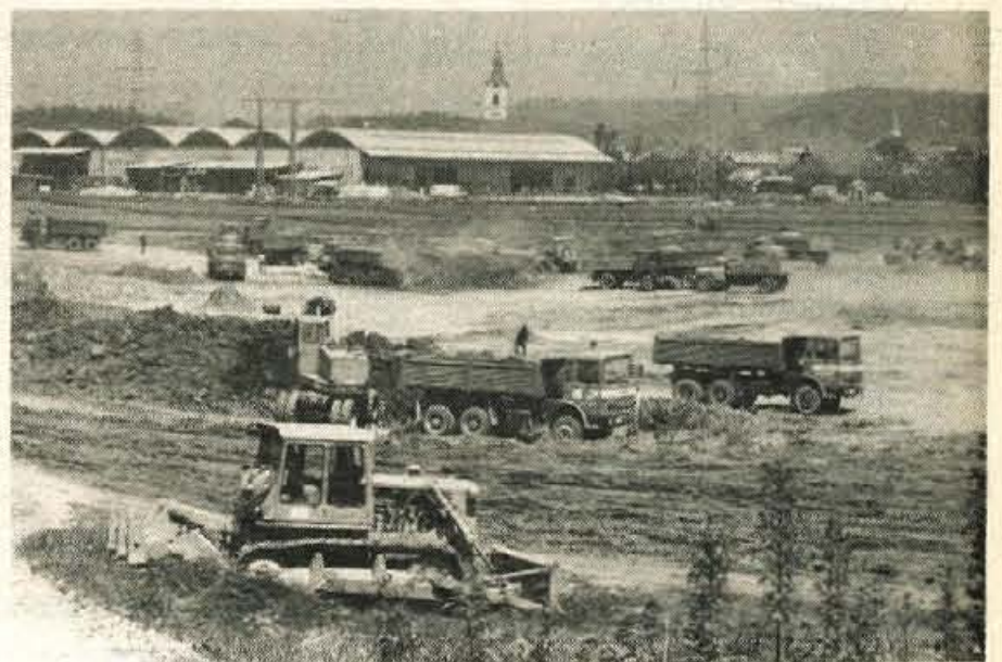
V NAKLEM GRADIJO — V Naklem pospešeno opravljajo zemeljska in osnovna pripravljala dela za gradnjo velikega blagovnega terminala, za katerega so v Naklem dobre možnosti, saj sta cestna in še posebno železniška povezava blizu. Graditelji upoštevajo pripombe krajevne skupnosti Naklo, le neznosen prah zaradi izsušene zemlje in prašne ceste do gradbišča nadleguje okolico ter se useda na bližnje drevje, predvsem pa sili v bližnje skladišče Živil. Graditelji bi morali prašenje preprečevati. (j.k) — Foto: F. Perdan
