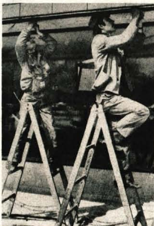
Tako pri novi restavraciji kot tudi pri domu je treba napeljati električne vode...
