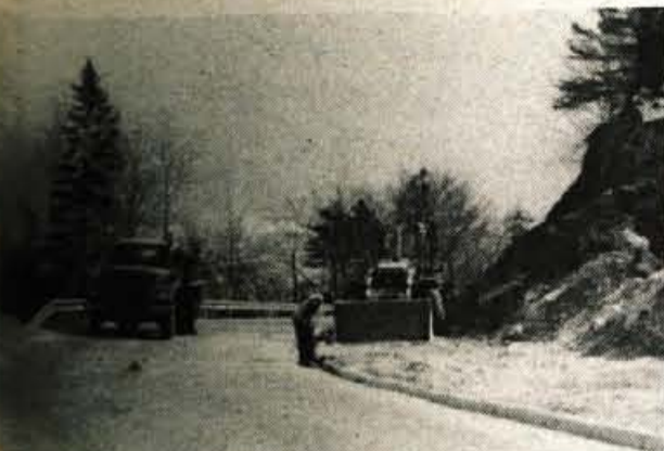
Blejska Dobrava – Nova cesta od Blejske Dobrave preko Poljan do Zgornjih Gorij je vsekakor velika pridobitev za vse prebivalce, ki prebivajo na tem območju. Priznati po njej že poteka, zdaj pa delavci Cestnega podjetja Kranj urejajo še pobočja med Poljanami in Dobravo. Predvsem bodo morali urediti še bankine.
