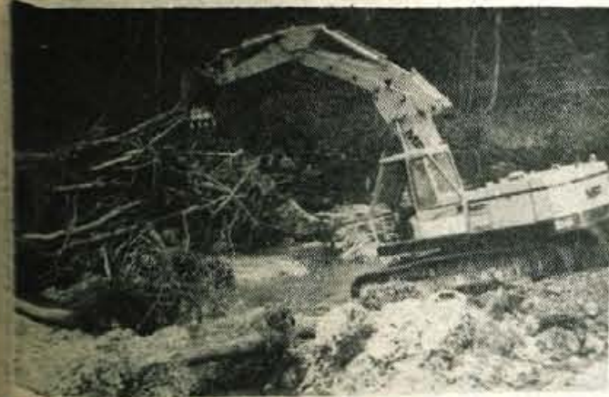
Podnart - Ob koncu januarja je Lipnica napravila precej škode na travnikih in v gozdovih. Nevarno se je lotila bregov in spodkotala ter odnesla številno dreve, ki je stalo v bližini struge. Delavci Vodne skupnosti Gorenjske so se zato odločili za čiščenje struge. - B. B.
