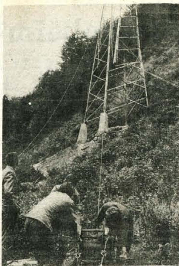
Gradnja 110 kV daljnovoda Bled - Bohinj, ki bo izredno pomemben za boljšo preskrbo z električno energijo v bohinjskem kotu. V začetku bo obratoval z močjo 35 kV in bo nadomeščal dotrajani daljnovod, ki poteka prek Pokljuke in Jelovice v Bohinj.
