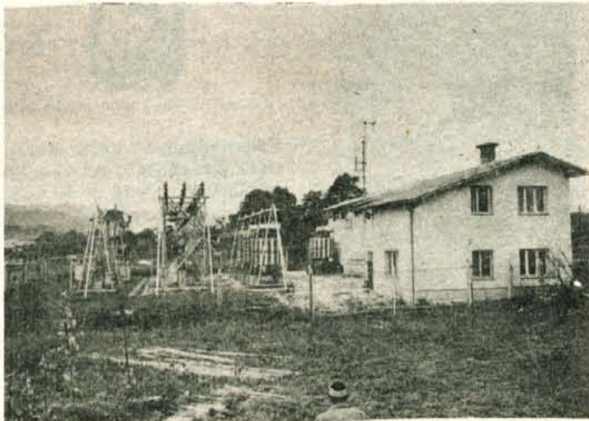
Razdelilna transformatorska postaja v Radovljici ob kateri bo v kratkem zgrajena nova 110 kV RTP. Gradnja se je že začela.
