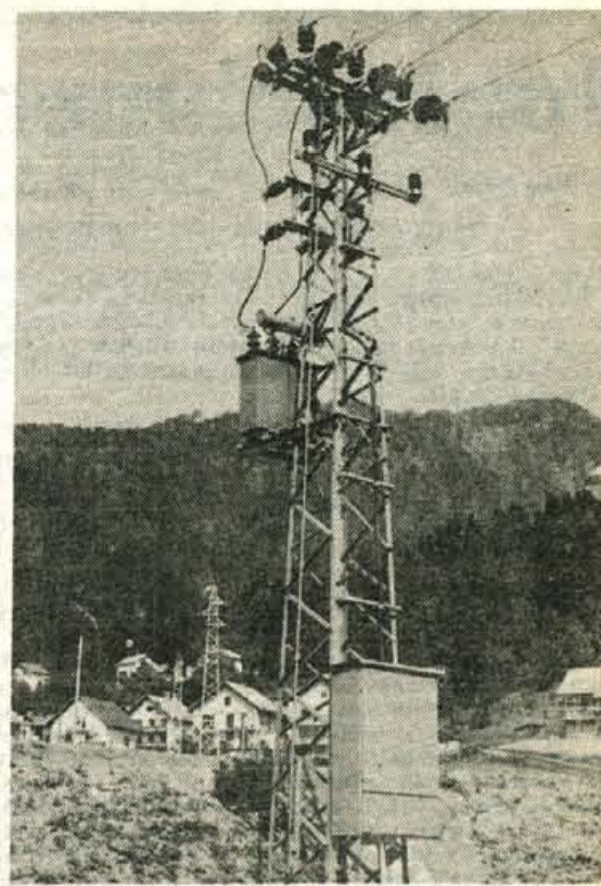
Eden od 250 transformatorjev na železnem jamboru za napajanje manjših vasi z električno energijo.
