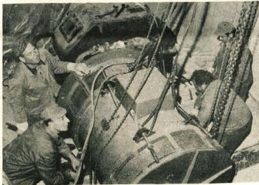
Montaža generatorja v hidroelektrarni Soteska pri Bohinju TOZD Elektro Sava Kranj. Elektrarna bo zgrajena na temeljih nekdanje žage in bo vključena v sredjenapetostno omrežje bohinjsko-blejskega območja. Moč nove elektrarne bo 400 kVA.
