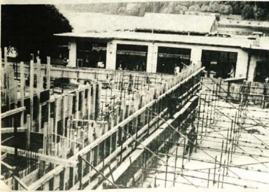
Bled – Delavci GIP Gradis nadaljujejo z deli ob Park hotelu in postavljajo zidove zgradbe, kjer bodo trgovski lokali. – Foto: B. B.
