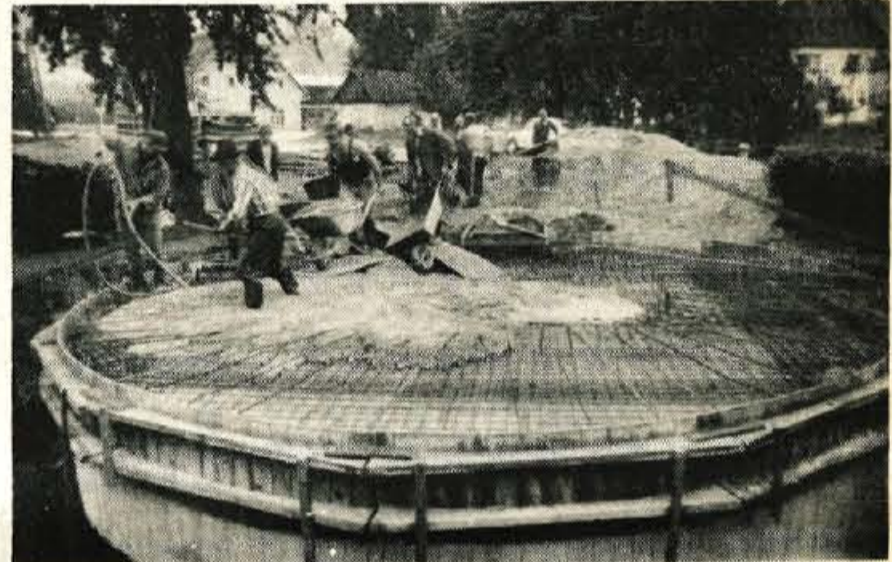
BREZJE — Prostovoljna gasilska enota Brezje na Gorenjskem si je na svojem območju s prostovoljnimi delom zgradila po krajih velike pokrite bazene za vodo. — Foto: F. D.
