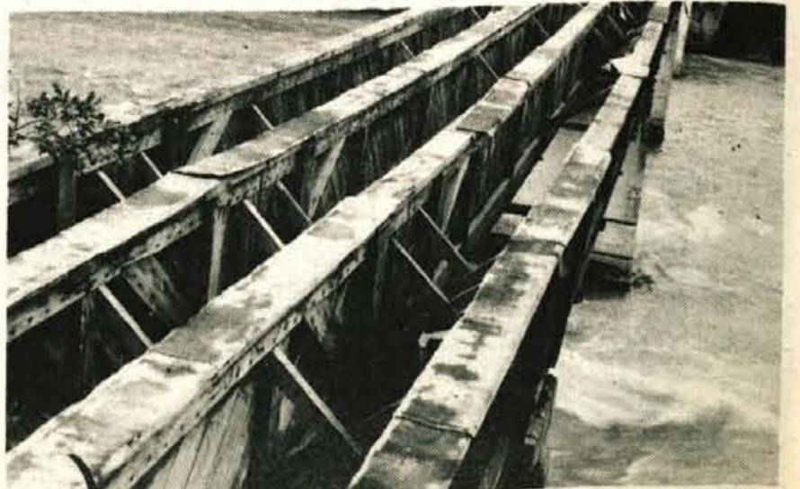
Podprt most čez Savo v Piškovci je »slaba vest« Zasipa, razen tega pa tudi radovljiške in jeseniške občine. Krajanje že več let terjajo popravilo. Kaže, da bodo prihodnje leto želje uslišane!
