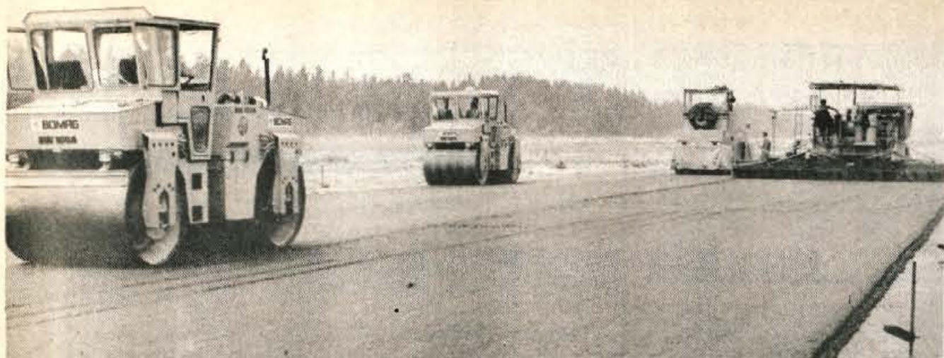
Na Brniku brez zamude – Modernizacija brniške vzletno-pristajalne steze in objektov ob njej poteka po programu. Izvajalci del so že ugradili na desetisoče kubičnih metrov asfalta. Kljub neugodnemu vremenu je graditeljem uspelo nadoknaditi zamujeno. Kaže, da bo nedelja za graditelje prvi prosti dan, ki so ga brez dvoma zaslužili, saj so doslej delali ob pomoči naj sodobnejše mehanizacije podnevi in ponoči. Brniška vzletno-pristajalna steza bo po novem dolga 3300 metrov in široka 60 metrov, imela pa bo ugrajene naj sodobnejše signalne in varnostne naprave. Na njej bodo lahko pristajala in vzletala naj sodobnejša, največja in najtežja letala s širokim trupom, ki lahko sprejmejo nekaj sto potnikov. (jk) – Foto: F. Predan
