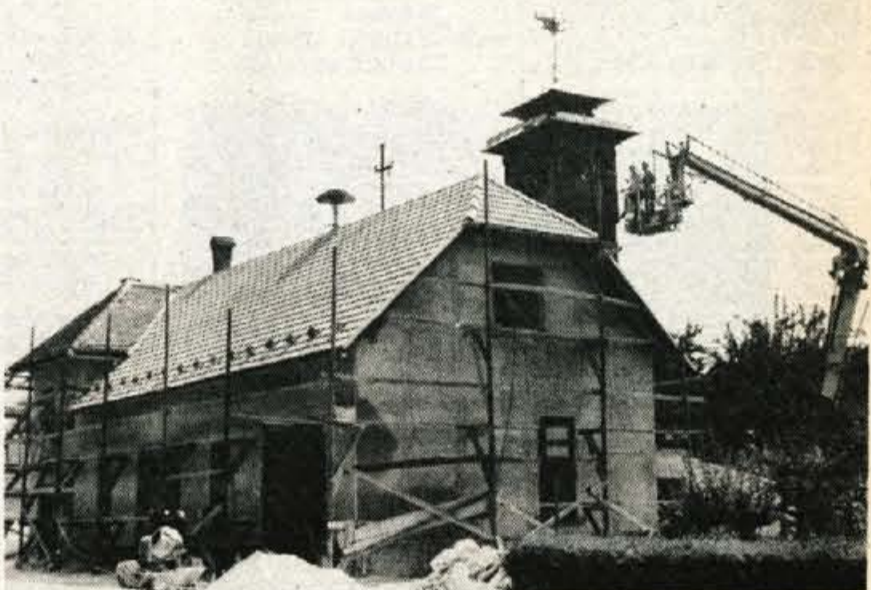
Lepši gasilski dom na Primskovem - Člani gasilskega društva Kranj-Primskovo, ki je bilo ustanovljeno leta 1922, deset let kasneje pa je bil zgrajen gasilski dom, so se lotili temeljite obnove svojega doma. S prostovoljnimi delom in pomočjo zidarskega mojstra Veljaka Bajraktareviča iz Kranja so obnovili fasado gasilskega doma, prepleškali stolp in modernizirali notranjost doma. Jutri bo namreč tudi za gasilce s Primskovega praznični dan. Pod pokroviteljstvom krajevné skupnosti in ob botrstvu Slave Zupančič in Jožeta Orsenika bodo jutri predali svojemu namenu novo 1200-litrsko motorno brizgalno rosenbauer, katere nakup so omogočili krajaní, saj so zbrali skoraj 10 milijonov starih dinarjev. Prezmem brizgalne bo združen z otvoritvijo nove šole. Gasilci pripravljajo za to priložnost tajo, kjer bo še posebno zanimiv prikaz uporabe Alpetourovih kmečkih cistern za gasilske namene. Pri obnovi doma na Primskovem je bila dobrodošla pomoč mehanizacije in članov kranjske poklicne čete, katere člani so hkrati tudi gasilci društva Kranj-Primskovo, ki se že dolgo uvršča v vrh gasilstva v kranjski občini. (jk) - Foto: F. Perdan
