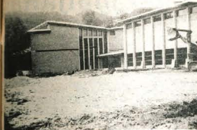
Gorje - Pri osnovni šoli Bratov Žvan v Gorjah pripravljajo teren za položitev asfalta. Ta prostor bo namenjen v bližini mladini za športne igre na prostem. Asfaltirali pa bodo tudi dohodno cesto do šole kjer je še vedno makadam. - Foto: Jože Ambrožič
