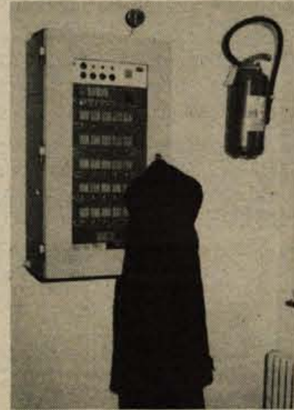
Po mnogih delovnih organizacijah že imajo aparate za javljanje požarov. Toda kaj takega kot kaže našposnetek, se vsekakor ne bi smelo dogajati. Plaš je nikakor ne sodi na tako občutljivo aparaturo. Tega se ne zaveda niti vratar, ki ga je obesil nanjo. Toda nekateri si kot vse kaže vso stvar predstavljajo popolnoma drugače. Jih bo treba boljše poučiti.
