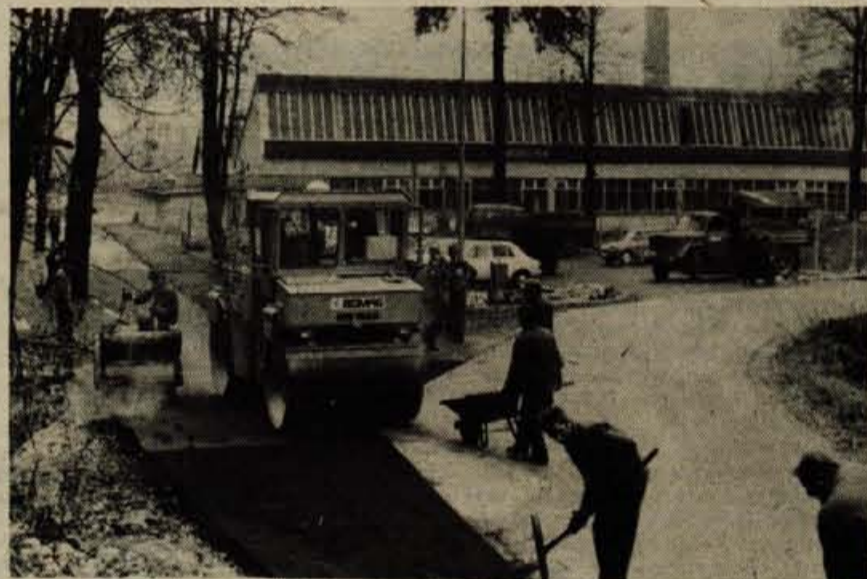
Nov asfalt pri Zvezdi - Tekstilna tovarna Zvezda v Kranju skrbi za lepši zunanji videz tovarne, saj h gradnji novih obratov sodi tudi urejanje okolice. Pred dnevi so asfaltirali del dohoda do tovarne in sam vhod v delovno organizacijo. (jk) - Foto: J. Zaplotnik
