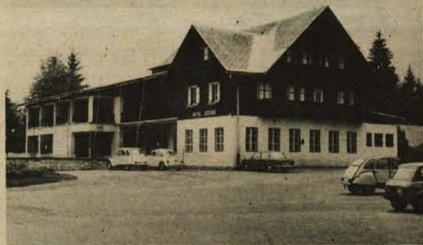
Bohinj – Po potresu poškodovani hotel Jezero je še vedno zaprt, denarja za obnovo ni ... – Foto: F. Perdan
