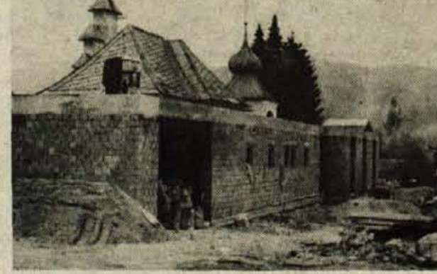
Bled — Delavci SGP Gorenje grade ob pokopališču na Bledu mrliške vežice, ki bodo predvidoma nared jeseni. Graditev financirajo iz samoprispevka prebivalcev Bleda. — Foto: B. B.
