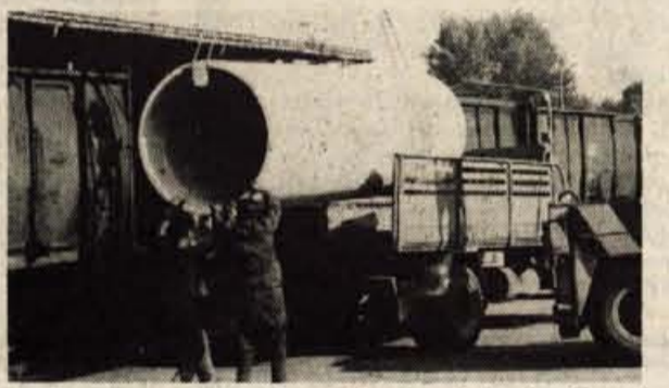
Kranj - Delavci SGP Gradbenec iz Kranja grade kanalizacijo za odpadno vodo tovarne Sava. Uporabljajo salonitne cevi iz Anhovega s premerom 120 cm. Transport tako velikih cevi je dokaj zahtevna naloga, zato so morali na tovarnjakih urediti posebne nosilce. (B. B.)
