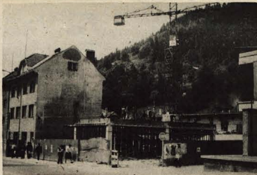
Jesenice - V centru 2 na Jesenicah, kjer bodo v prihodnje rušili več starih objektov in postavili nove zgradbe in stanovanjske hiše, zdaj poleg Ljubljanske banke grade novo poslopje. Tako se bo kolektivne banke kmalu preselil v nove, ustrežnejše poslovne prostore... - Foto: F. Perdan.
