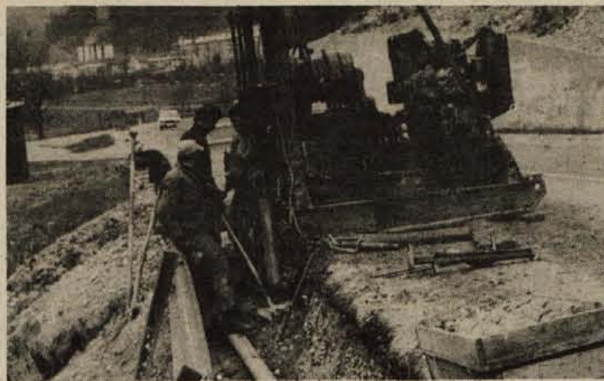
Med deževjem pozimi se je pogreznil del magistralne ceste zahodno od Soteske pri Koroški Beli. Tu bo potrebno zgraditi oporni zid, da se cesta ne bo več pogrezala. - Foto: G. B.
