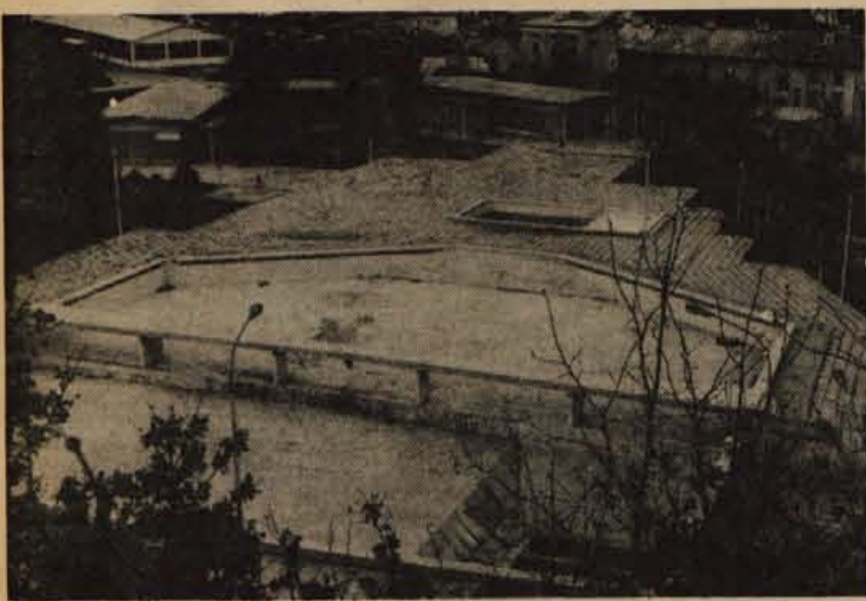
Tržiško letno kopalništvo je bilo dolgo med najlepšimi v Sloveniji. Žal ga je že načel zob časa. Kopalniška stavba in naprave so dotrajane in pokvarjene. Zato je bilo lani kopalništvo sredi sezone nekaj dni že zaprto. Do letošnje sezone ga bo nujno popraviti, sicer ga predvsem inšpekcije ne bodo dovolile odpreti. Časa ni na pretek. Tržičani nameravajo letno kopalništvo popraviti s sredstvi zadnjega samopriskrpeka. (jk) - Foto: F. Predan
