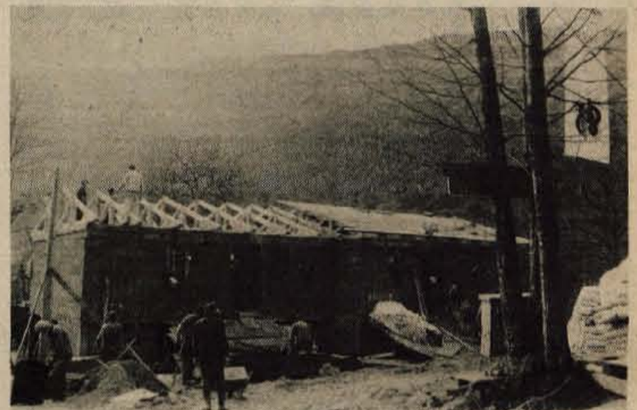
Dvojček, ki ga je kolektiv LIP Bled namenil kot pomoč prizadetim v Posočju. Stanovanjski objekt v vasi Kamno, zgrajen pa bo do 5. novembra.
