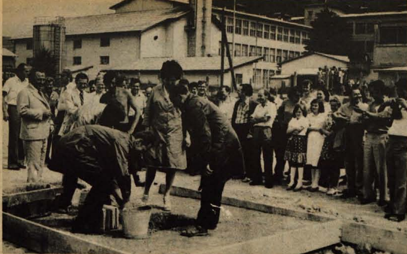
30. aprila prihodnje leto ob 30-letnici Alpine bo skladiščna hala zgrajena. — Foto: F. Perdan
