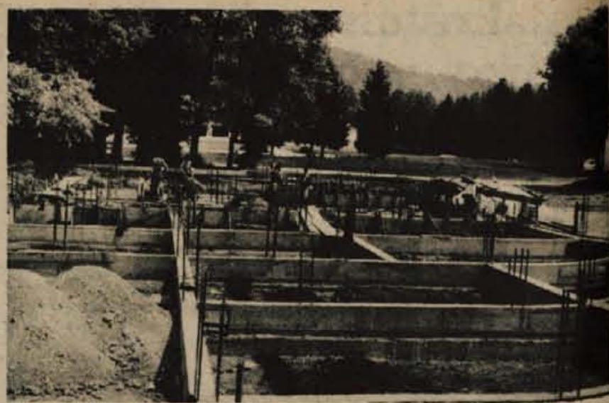
V KRIŽAH GRADIJO NOV VRTEC - Okrog 20. maja so začeli v bližini osnovne šole Kokrškega odreda v Križah graditi nov otroški vrtec za 120 otrok. Vzgojnovarstveni objekt bo zgrajen do konca leta, gradnja pa Tržičani financirajo s sredstvi samoprispevka, ki bo zaključen letošnji jesen. Odbor za gradnjo in adaptacijo osnovnih šol in vrtcev v tržički občini je gradnjo zaupal Splošnemu gradbenemu podjetju Tržič. O ostalih investicijah v vzgojnovarstvene in izobraževalne objekte v občini pa se bodo odločali na odboru za gradnjo in popravilo šol in vrtcev, na skupščini izobraževalne skupnosti in občinski skupščini. Pri tem bodo upoštevali tudi stališča občinske skupščine in družbenopolitičnih organizacij do razvoja osnovnošolske in vzgojnovarstvene mreže v tržički občini. (jk) - Foto: F. Perdan
