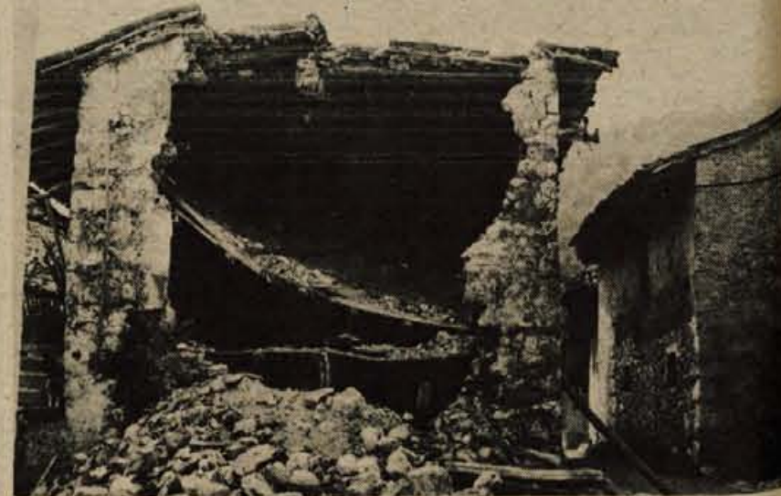
V Breginju so z rdečo piko, ki pomeni, da je potrebno rušiti, zaznamovane skoraj vse hiše. Precej stavb pa je skoraj do temeljev porušil že potres.
