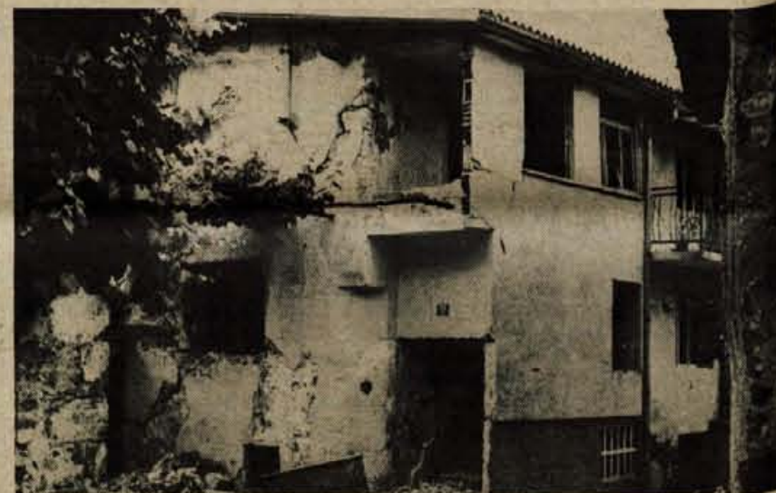
V Podbeli je majski potres 48 od 70 hiš tako močno poškodoval, da jih bo potrebno porušiti. Druge pa so potrebne temeljitega popravila.
