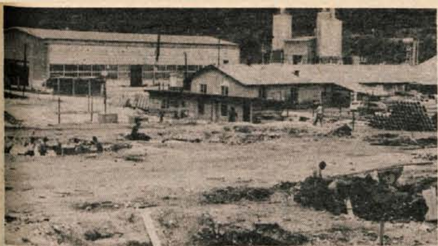
Na Plavškem travniku grade delavci SGP Sava z Jesenic veliko pokrito skladišče in upravno zgradbo za trgovsko podjetje Universal. Universal bo povečal tudi industrijski tir. — Foto: B. B.
