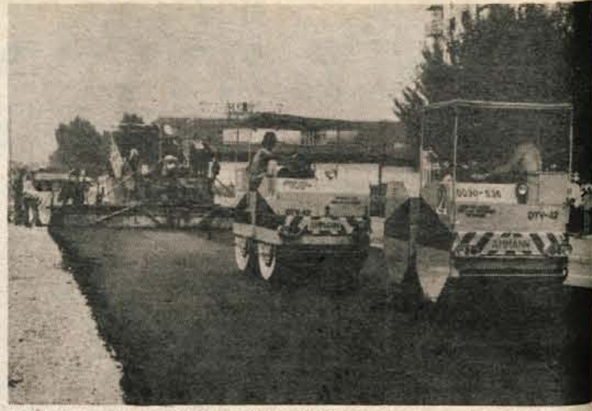
ASFALTIRANJE CESTE PROTI KOKRICI — Cestno podjetje iz Kranja je začelo v sredo vgrajevati novo asfaltno prevleko na Cesti JLA od Kranja proti Kokrici. Ker delo dobro napreduje, je bil včeraj že vgrajen asfalt do mostu na Kokrici. (jk) — Foto: F. Perdan
