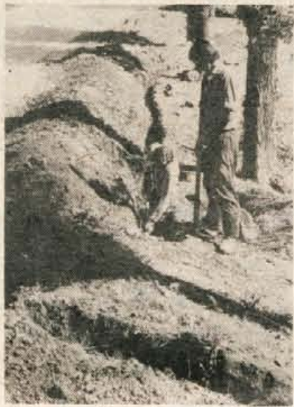
Delavci podjetja Tegrad iz Ljublja- ne polagajo v Finžgarjevi ulici v Lescah kable za novo telefonsko na- peljavo. Število telefonskih naroč- nikov v tem delu Lesc se je povečalo, sedanja napeljava pa je za večje število telefonskih priključkov pre- šibka. — B. B.
