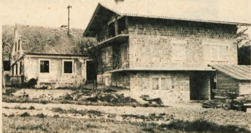
Hišo Jožeta Horvata iz Serovega je potres močno načel. Komisija jo je uvrstila v IV. kategorijo in jo bo potrebno porušiti, ker je bivanje v njej nevarno. Novo so mu pomagali zgraditi delavci gradbenega podjetja Projekt iz Kranja. Kredit zanjo pa so prispevali delavci LTH iz Škofje Loke.
