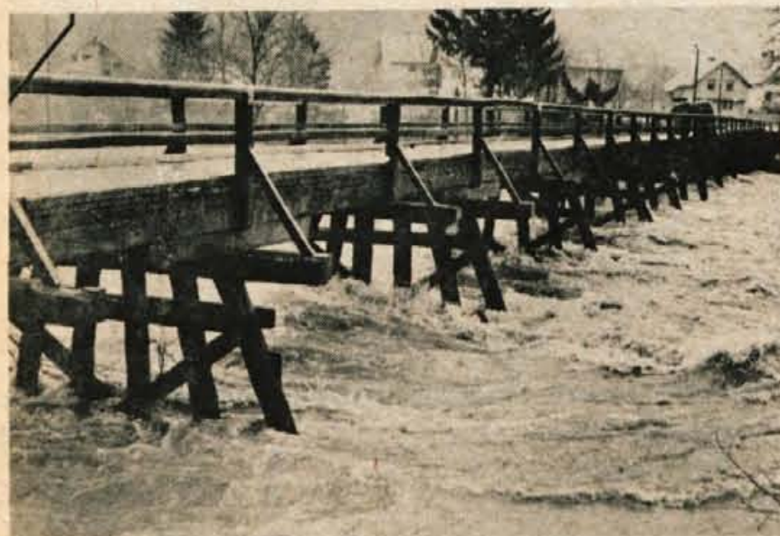
Most v Otočah se je komaj upiral narasli Savi, zato so organizirali stalno dežurno in varovalno službo. Da vodni nanos in plavajoča debela ne bi porušila opornikov, so bili nevarnost primorani odstranjevati tudi s pomočjo razstreliva. Verjetno pa ne bi bilo napak most ojačati ali zgraditi novega, ki bo lažje kljuboval vodni sili. (jk) - Foto: F. Perdan
