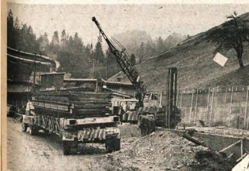
V začetku septembra je podjetje Jelovica iz Škofje Loke začelo povečevati svoj obrat v Sovodnju v Poljanski dolini. Dela izvaja SGP Tehnik iz Škofje Loke, konstrukcijo pa postavlja kranjsko podjetje Kovinar. Gradbena dela naj bi bila po predvidevanjih končana marca, vselitev pa je predvidena za mesec maj. Število delavcev v sovodnjem obratu Jelovice se ne bo bistveno povečalo, saj se je škofjeloško podjetje za gradnjo novih prostorov v tem kraju odločilo predvsem zato, ker so bili dosednji občutno premajhni. Novozgrajeni prostori bodo imeli 400 kvadratnih metrov površine. (jg) — Foto: F. Perdan
