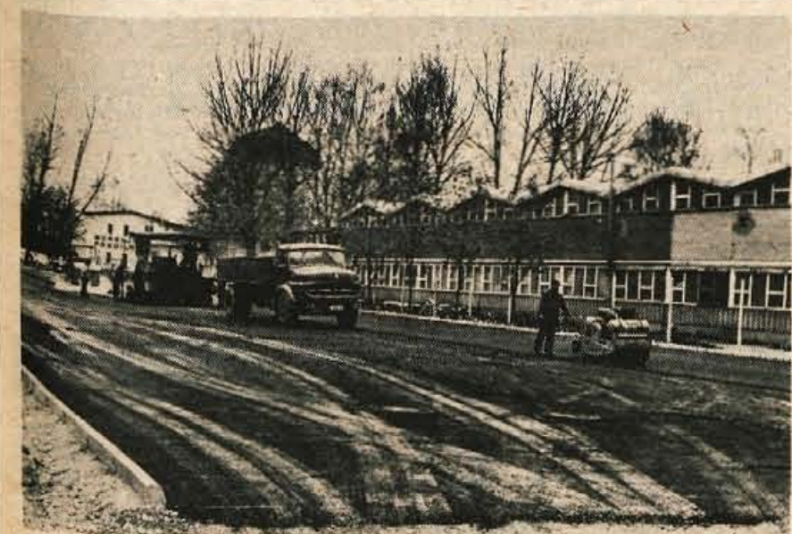
Te dni delavci Komunalnega podjetja iz Ljubljane urejajo parkirni prostor in dvorišče ob Gorenjski predilnici v Škofji Loki. Asfalt bodo položili na površini okrog 2000 kvadratnih metrov, celotna investicija pa bo znašala približno 200.000 din. Vsa dela bodo končana do sredine prihodnjega tedna. (jg) — Foto: F. Perdan
