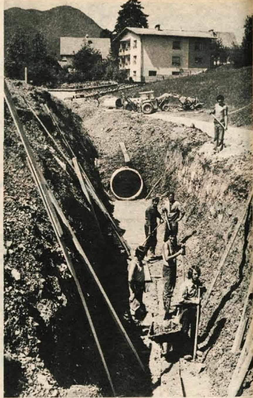
V Škofji Loki te dni nadaljujejo s polaganjem cevovoda glavne kanalizacije, ki bo potekal od Trate do centralne čistilne naprave na Suhi. Delavci SGP Tehnik iz Škofje Loke so začeli z delom že spomladi, trenutno pa polagajo cevi s premerom 1,30 metra ob cesti proti Plevni. Zaradi del je prometna žila od Plevne proti Lipici zaprta za ves promet že od sredine julija in bo ostala še nekaj časa. Vozniki motornih vozil, ki so namenjeni proti Ljubljani, se bodo torej še nekaj časa morali posluževati obvoza prek Trate. Celotna dolžina cevovoda je približno 2000 metrov, seveda pa pri tem niso všteti mnogi priključki. Kanalizacija bo predvidoma dokončno urejena še pred zimo. (JG) — Foto: F. Perdan
