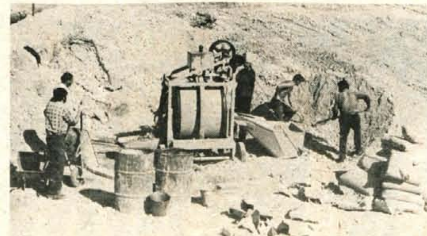
Delavci Vodne skupnosti Kranj grade med Hrušico in Jesenicami betonski jez, na katerem bo posebna naprava, tako imenovani »mehe«, usmerjal Savo Dolinko po že zgrajenem pretočnem kanalu ali na prodišče, s katerega bodo delavci SGP Sava črpali prod za novo separacijo. — B. B.
