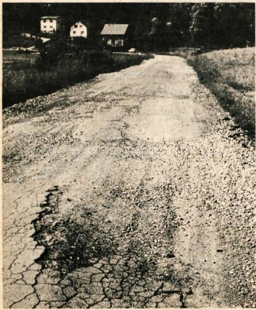
Medtem ko je cesta od Tenetiš do začeta Gorič zasilno zakrpana, pa je odsek od Gorič do Golnika, od koder je fotografija, izredno slab. Asfaltna prevleka je zaradi vsakdanjega prometa, še posebno pa zaradi tovornjakov, ki so vozili gradbeni material in asfalt na novo cesto Golnik—Senično, skoraj popolnoma uničena. Vožnja po takšni cesti ni prijetna. Še posebno za težke bolnike, ki jih reševalni avtomobili vsak dan prevažajo na Golnik ali obratno! (jk) — Foto: F. Perdan
