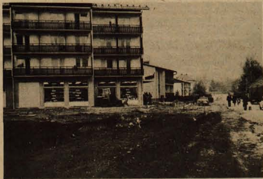
Med Finčgarjevo in Savsko cesto v Lesceh, kjer so stanovanjski bloki Verige Lesce in zasebne stanovanjske hiše delavcev iz te tovarne, gradbeno podjetje Gorenje iz Radovljice ureja okolico. Asfaltni trati bodo dvorišča in parkirne prostore, zelenice pa bodo uredili stanovalci sami. Denar za ureditev tega dela Lesce je prispevala tovarna Veriga Lesce — Foto: A. Zalar
