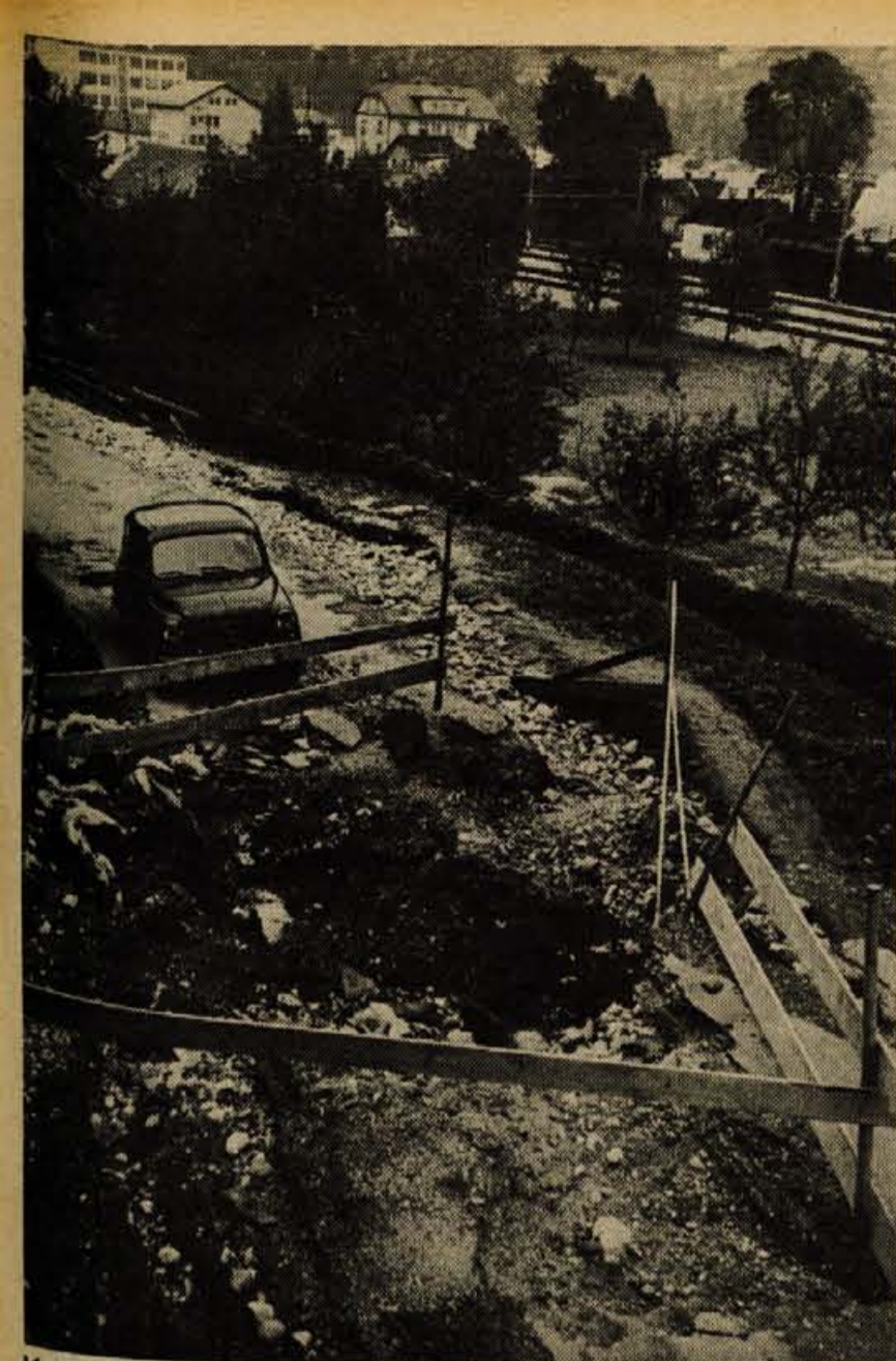
Močno deževje ta in minuli teden je povzročilo škodo tudi na spodnjem delu še neurejene Delavske ceste v Kranju. Voda iz zgornjega dela nove kanalizacije je zamašila kanalizacijo v spodnjem delu in zato drvela po cesti ter vdiral v kleti in stanovanja. Zato je bilo treba odpreti staro kanalizacijo in odstraniti ovire. Prebivalci tega dela Kranja se sedaj bojijo, da bo tako razkopana cesta ostala še lep čas. Pravijo, da so odgovorni obljubili, da bodo že naslednji dan okvaro popravili. Od takrat pa je minilo že nekaj dni in vse je še tako kot je bilo. Ker dela pri urejanju Delavske ceste v Kranju že tako potekajo zelo počasi, prebivalce skrbi, da razkopano cesto navsezadnje ne bo pokrili sneg. — A. Ž. — Foto: F. Perdan
