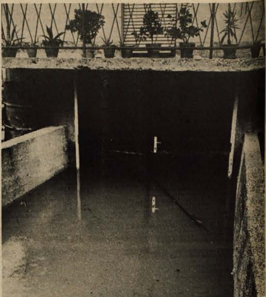
Pri stanovanjski hiši Jožeta Otoničarja, Zgornje Duplje 65, je voda skoraj do polovice zalila vhod v garažo
