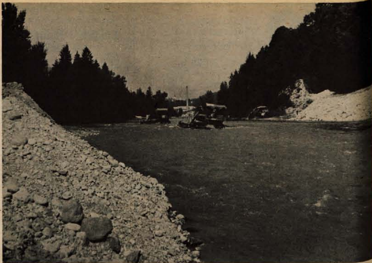
Z buldožerji so v sredo dopoldne odprli novo strugo Save v Zarici — Foto: A. Zalar
