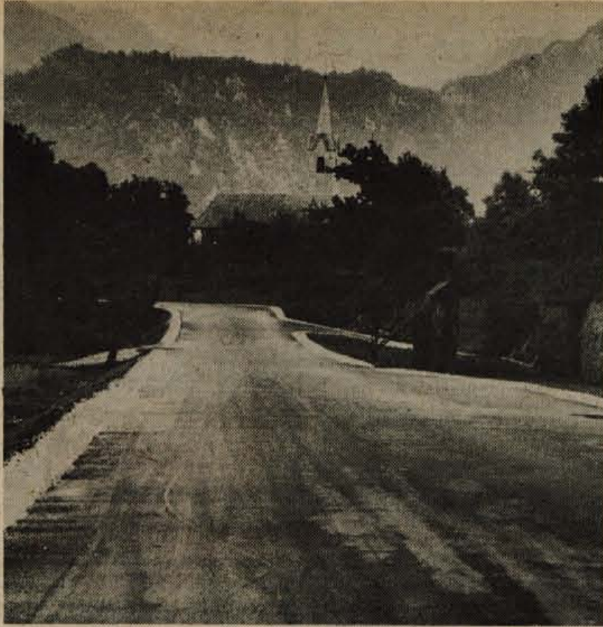
Cestno podjetje iz Kranja je pred dobrim tednom vgradilo asfalt na cesti od glavne ceste proti Vrbi. Asfaltni trak je precej dolg, saj se začne pri glavni cesti, teče mimo Prešernove rojstne hiše in se končuje pri gostišču. Ob asfaltirani cesti so urejena tudi parkirna mesta. Dela, ki so potrebna pred vgraditvijo asfalta, je opravilo podjetje Kovinar z Jesenic. (jk) — Foto: F. Perdan
