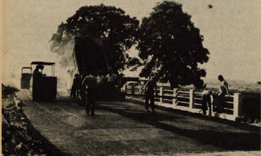
V začetku tedna je Cestno podjetje iz Kranja obnovilo tri mostove na cesti Kranj—Jesenice v radovljjski občini. Granitne kocke so zamenjali z asfaltom na mostu, kjer je odcep za Begunje in za Radovljico, na odcepu za Lesce in na mostu pred križiščem za Bled. — Foto: F. Perdan
