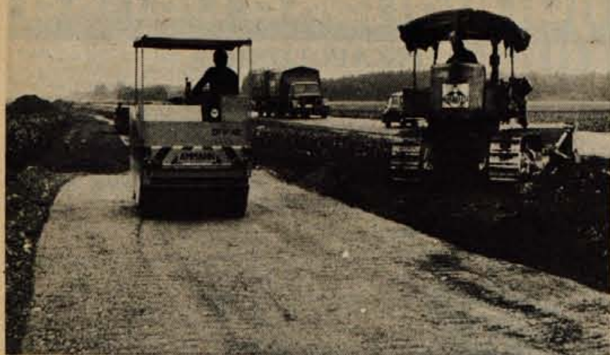
Ker namerava kranjska občina letos popraviti in razširiti cesto proti Brniku oziroma Senčurju, so začeli delavci Cestnega podjetja iz Kranja te dni urejevati obvozno cesto, po kateri bo tekel promet med rekonstrukcijo glavne ceste. (jk) — Foto: F. Perdan
