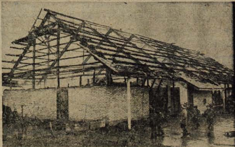
V torek, 2. januarja, ob 20.25 je izbruhnil požar v samopostrežni trgovini Zivila v Zg. Bitnjah. Goreti je začelo v levem delu skladišča, kjer so bili prehrabeni predmeti, cigarete, papir in več steklenic špirta. Ogenj se je razširil na vse skladišče, zajel je tudi bife in mesnico. Kljub hitri intervenciji PGD Zg. Bitnje požara niso mogli pogasiti. Samopostrežna trgovina, bife in mesnica so pogoreli do tal. Škode je za okoli tri milijone novih din. Vzroke požara še raziskujejo. — L. M. — Foto: F. Perdan
