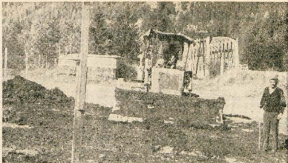
Delavci SGP Sava so novembra začeli v Kranjski gori graditi obvoznico. Od sedanje glavne ceste se bo odcepila pri Kozarju, nanjo se bo priključila blizu Jelenove žage med Kranjsko goro in Podkorenom. — Foto: B. Blenkuš
