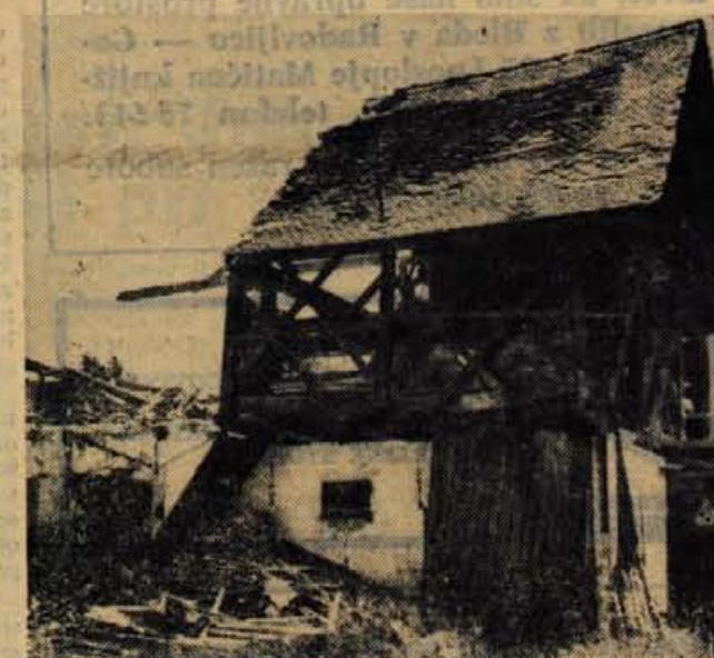
Zadrugi škedenj v Poljčah zaradi dotrajanosti letošnjo zimo ni zdržal teže snega. Stavbe po selitvi kmetijskega posestva v nove prostore na Blate nihče več ni popravil in zato ni bilo pričakovati drugega kot da se bo porušila. Čeprav je v Poljčah še nekaj podobnih kamnov spotike, je podrt hlev najbolj bodeč. Kot so nam povedali domačini, je stavbo nekdo že odkupil ter jo bo preuredil v stanovanjsko hišo. (Jk) — Foto: F. Perdan
