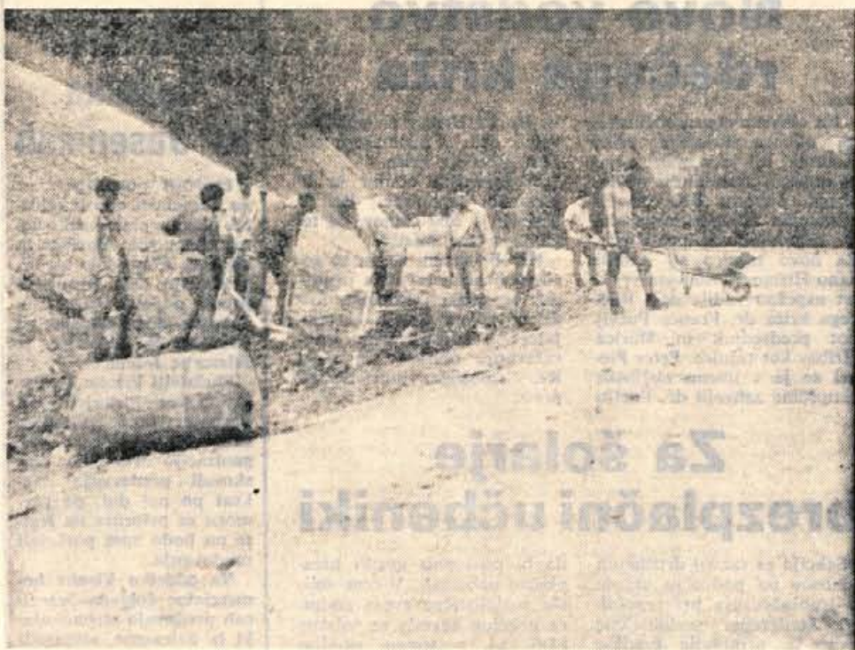
REKONSTRUKCIJA CESTE KRNICIA—POKLJUKA — Ta mesec je bila končana cesta od Zatrnika. Cesta je dolga štiri kilometre, široka pa šest metrov. Rekonstrukcijo sta financirala GG Bled in občinska skupščina, zemeljska in vsa druga dela pa so opravili pripadniki JLA — Na sliki: Zadnja dela pred dokončno ureditvijo. — Foto: R. Knežević
