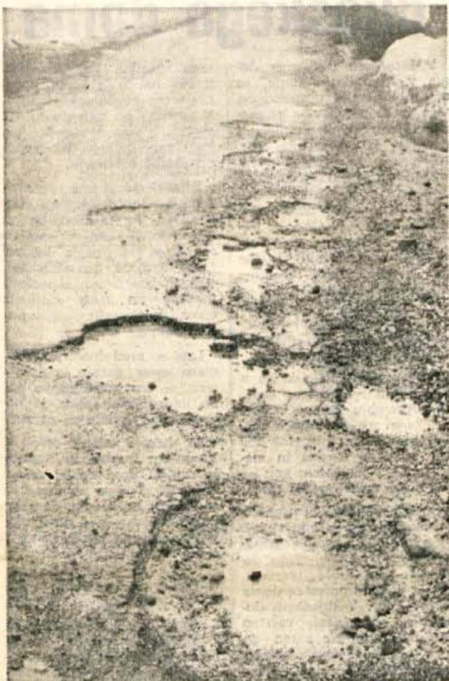
Stara pesem se ponavlja: sneg in zmrzal sta znova načela cesto Zabnica-Kranj, ki nemo zahteva, naj jo vendarle že obnovijo. Najbrž škilil čez občinsko mejo, na loško stran. — Foto: F. Perdan
