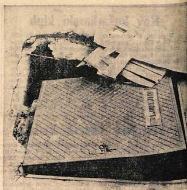
Na Stritarjevi cesti v Kranju je že nekaj dni odprt jašek, ki je le za silo pokrit z deskami. Nevarnost za pešce! — Foto: F. Perdan
