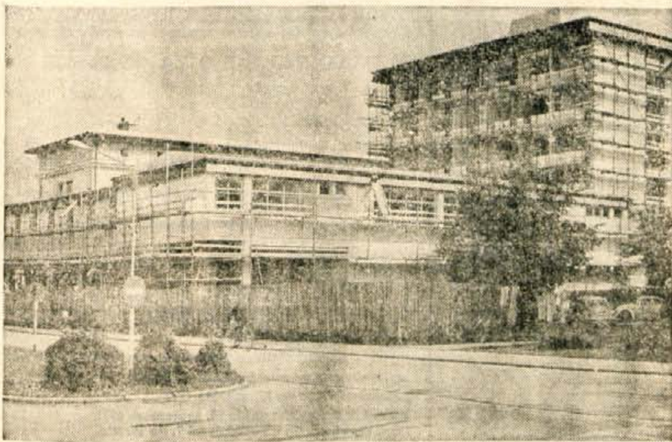
Kaže, da bo gradbeno podjetje Gorenje Radovljica z deli na hotelu Grajski dvor v Radovljici končalo do 1. julija. — Foto: A. Zalar
