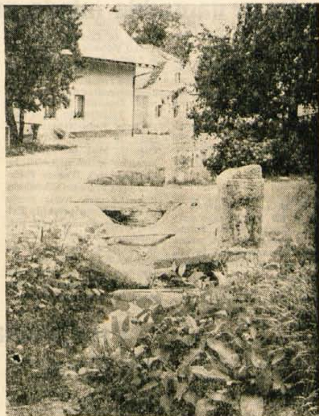
Za mesec dni sameva porušen most v Poljčah. Nezavarovan in nevaren promet. Ni pa nikogar, ki bi se pobrigal, da ga zavaruje ali pa dokončno popravi. Pustimo to in počakajmo na prometno ali kako drugo nesrečo, verjetno prej ne bo nič. — Foto: M. S.
