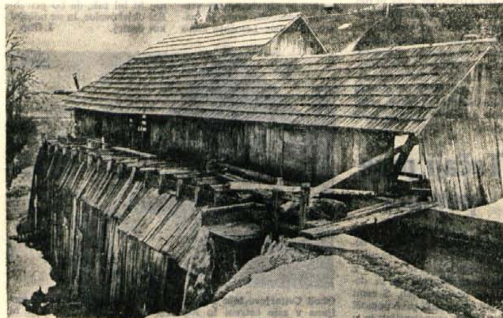
Mlin in žaga v Praprotnem sta med najstarejšimi v Selški dolini. Čeprav sta objekta stara že preko 200 let, sta še izredno dobro ohranjena. Janko Dolenc, sin lastnika mlina in žage nam je povedal, da so ju pred leti popravili po načrtih zavoda za spomeniško varstvo. Danes ju ne uporabljajo več. Janko nam je povedal, da je imel pred tremi leti še mlinarsko obrt, ki se danes več ne izplača, saj je žita v dolini vedno manj in se je zato raje zaposlil v LTH. Pravi, da melje le za potrebe domačije. (Jk) — Foto: F. Perdan
