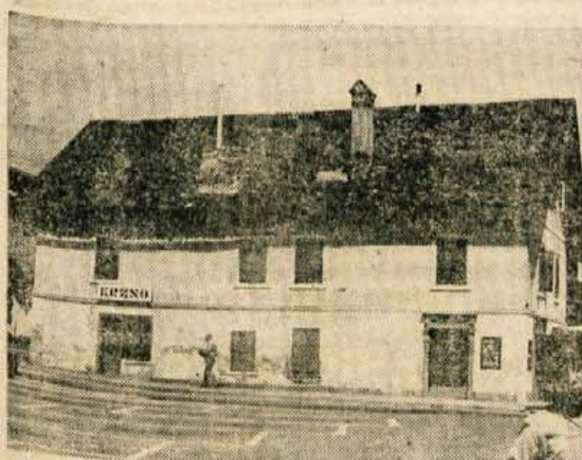
V središču Bleda nasproti hotela Jelovica, stoji stara stavba. Njeni dimniki grozijo, da se bodo zdaj, zdaj zrušili. Uprava Jelovice je že večkrat opozorila pristojne organe naj stavbo popravijo, ker takšna kot je prav gotovo ne sodi na Bled, ki je lani zasedel v urejenosti in lepoti prvo mesto med turističnimi mestil. Kljub temu pa je stavba, sedaj, ko smo sredi turistične sezone in jo gostje lahko opazujejo iz dnevnih prostorov hotela, še vedno nepopravljena. — Foto: M. Kunšič
