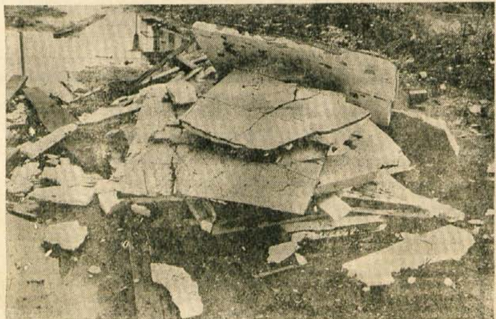
V novozgrajenem stanovanjskem naselju Vodovodni stolp v Kranju se že dlje časa kruši omet z dveh stolpnic. Med neurjem v noči od torka na sredo je z ene od stolpnic spet odpadle precej ometa. — Foto: F. Perdan
