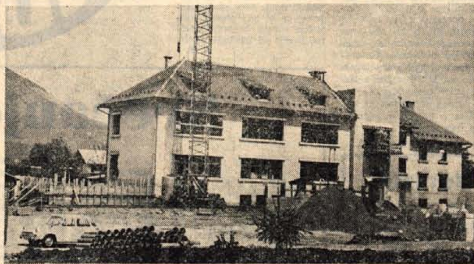
Pred štirinajstim dnevi so v Lescah začeli graditi novo šolo — Foto: F. Perdan
