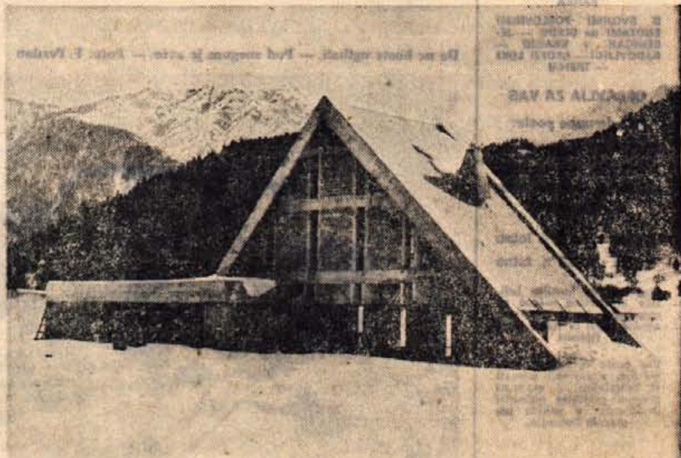
Ratečani pravijo, da je nedokončana stavba ob državni meji v Ratečah lep spomenik... Pred dvema letoma je namreč turistična agencija Putnik iz Beograda, željna denarcev, začela graditi menjalnico. Dela so se naenkrat ustavila in v nedokončani stavbi je že dobro leto mir. Po nepotrjenih govoricah je »spomenik« veljal agencijo že 80 starih milijonov. (Jk) — Foto: F. Perdan
